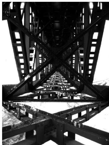
Figure 11. Fotografie de travadure tubolâr dal puint (il plan dai binaris al è adalt!). Come che si viôt, la vernîs e je stacade in diversis parts des tràfs diagonâls inferiôrs de reticolâr, e si viôt il primer di colôr naranç (Març 2007).
